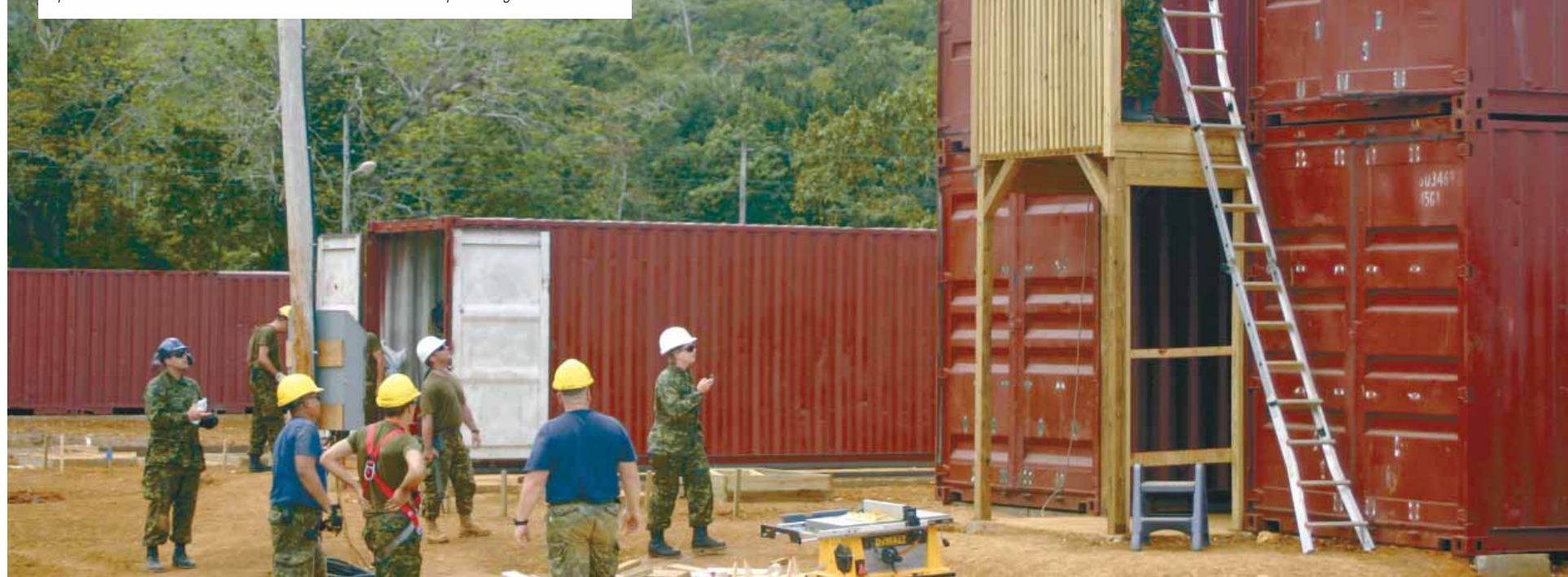
Le Mat 1 Robert Boucher, de l'École de la Flotte de la BFC Esquimalt, soude une poutre à l'intérieur de l'un des conteneurs maritimes au camp Moneague.
