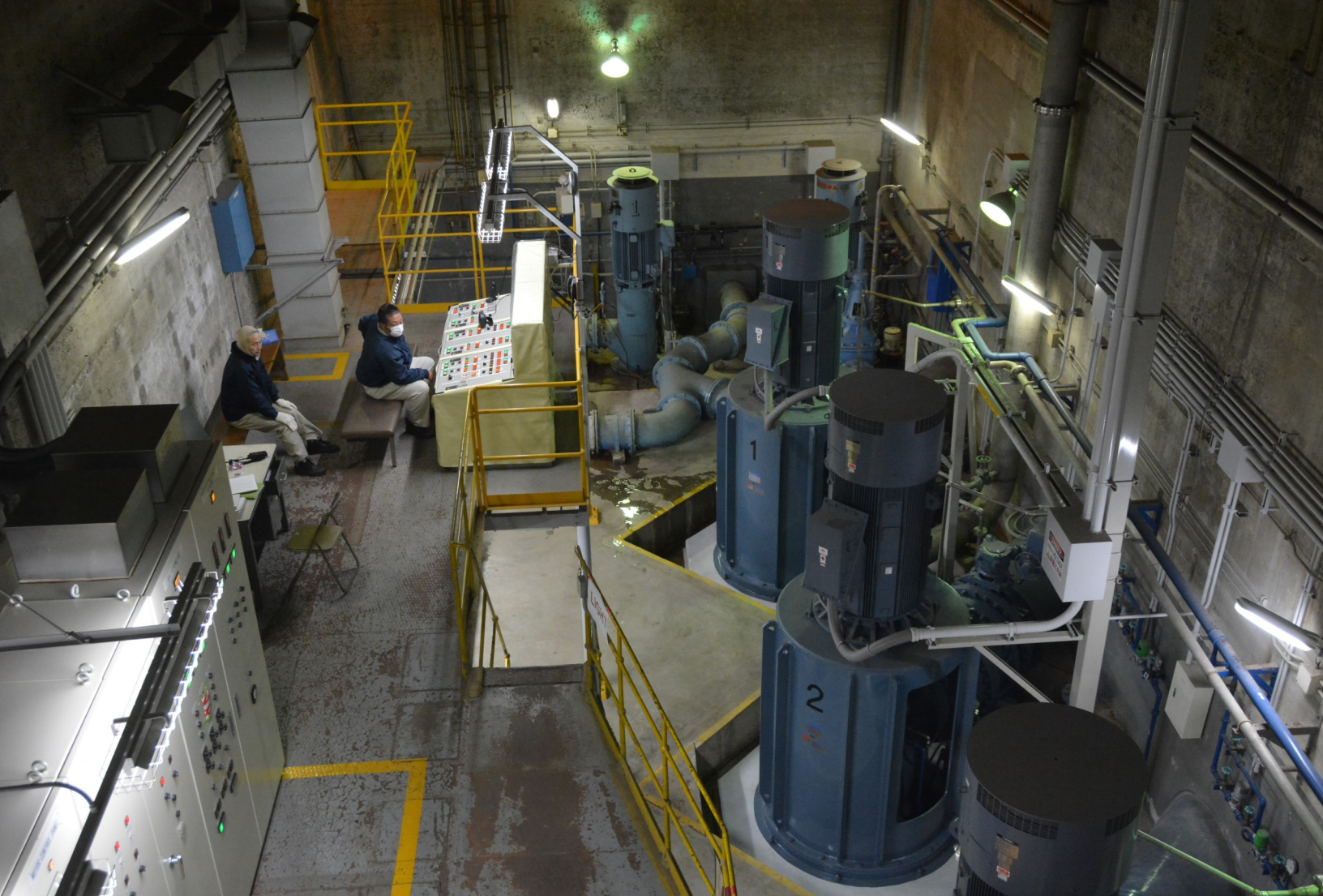
① (上) 2017年3月10日 横須賀 — 地下のポンプ室をモニターするSRF-JRMCプロダクション作業工場のスタッフ。これらポンプを使用してドライドックへの注水と排水が行われる。(写真: 磯部良 FLEACT横須賀広報課)
